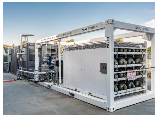
200 kW SOEC unit in Los Angeles, USA
